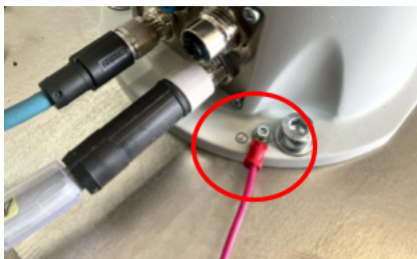
Mise à la terre du manipulateur.
